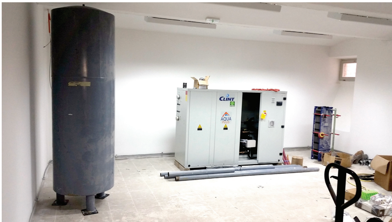
Geo-termalni sustav grijanja i hlađenja
