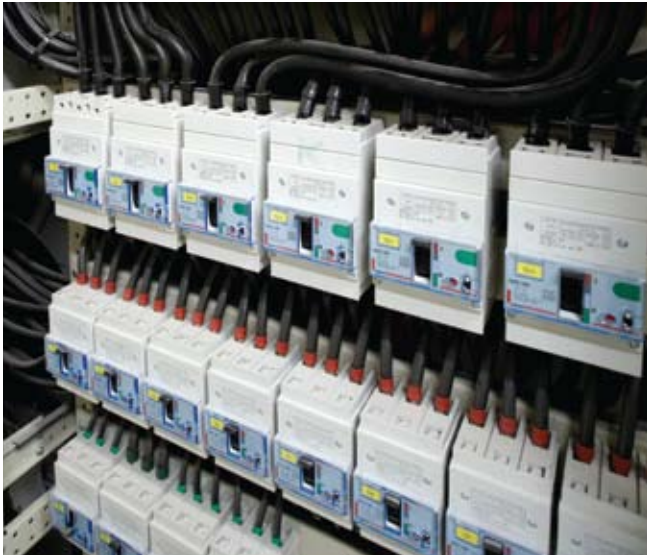
Instalirane su nove razvodne ploče
