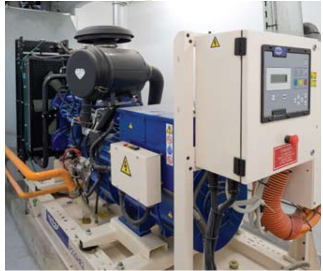
U podrumu je instaliran agregat
